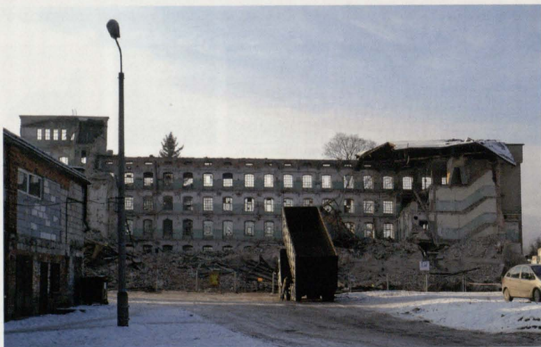
Zburzona przędzalnia lnu w Mysłakowicach
