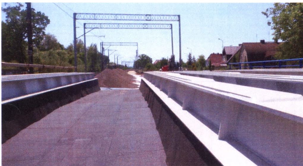
Ryc. nr 19. Maty przeciwwibracyjne na moście nad Sąciecznicą (Żmigród) – fot. własna
