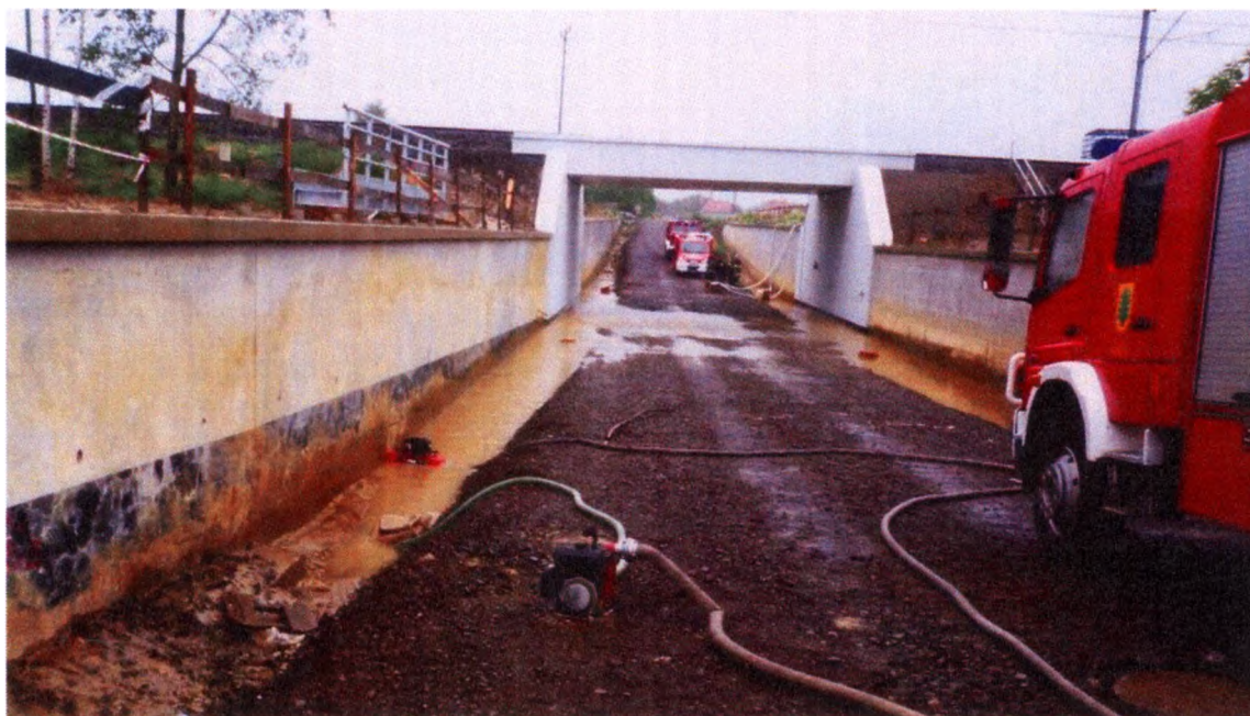
Ryc. nr 28. Pompowanie wody spod wiaduktu w km 31,815 – fot. własna
