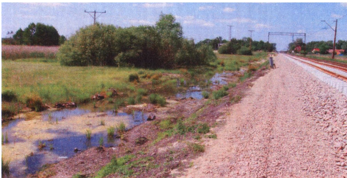
Ryc. nr 30. Rozlewisko spowodowane brakiem odwodnienia torów – fot. własna
