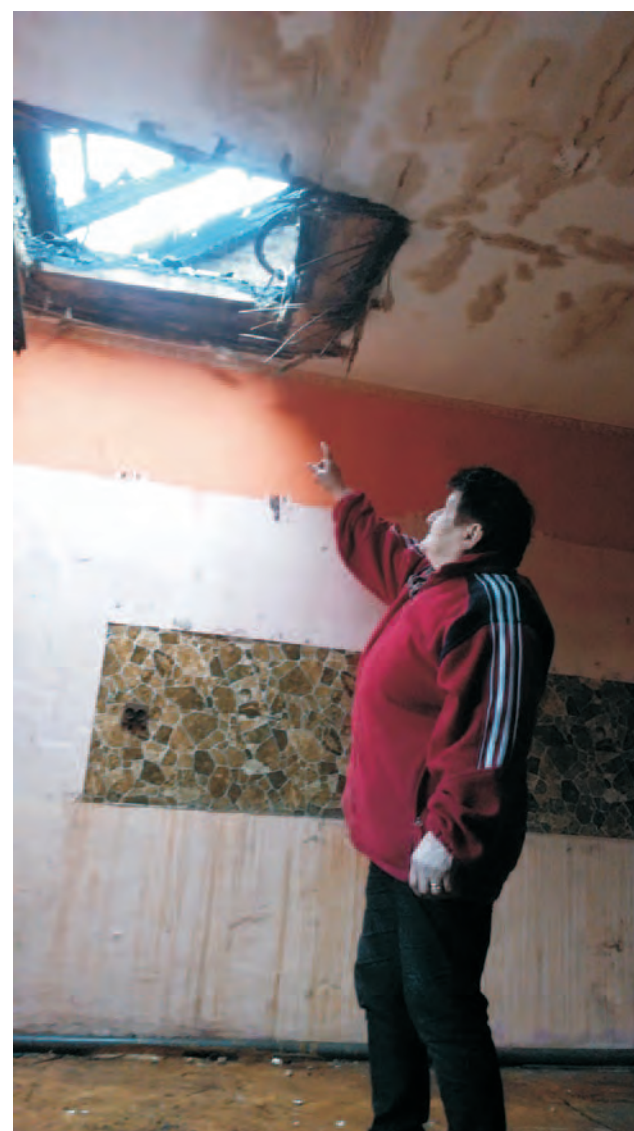
Dziury w stropie, powstałe po pożarze
