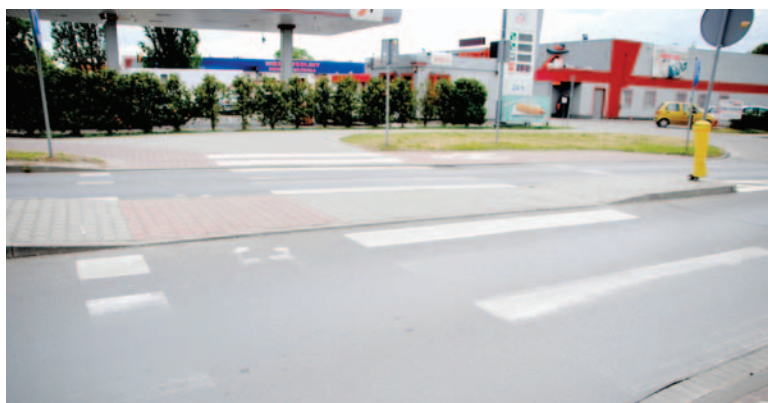
Na jezdni ul. Oławskiej po poziomym znaku roweru nie ma śladu
