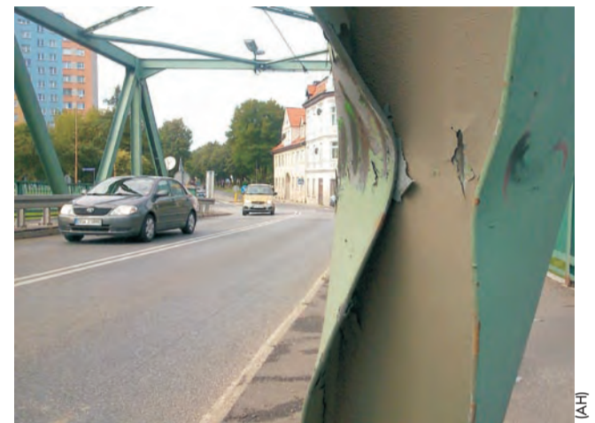
Oto przyczyna - uszkodzone przęsło
