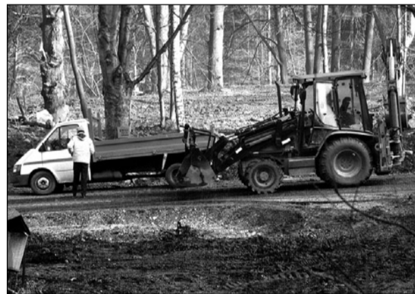
JEW chce przeznaczyć na remonty i budowy swoich obiektów w tym roku 40 milionów złotych. Na zdjęciu powstające zaplecze elektrowni Bobrowice 4
