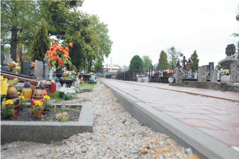
Po dużych opadach tworzą się kałuże wokół grobów. Woda nie ma gdzie odpływać
