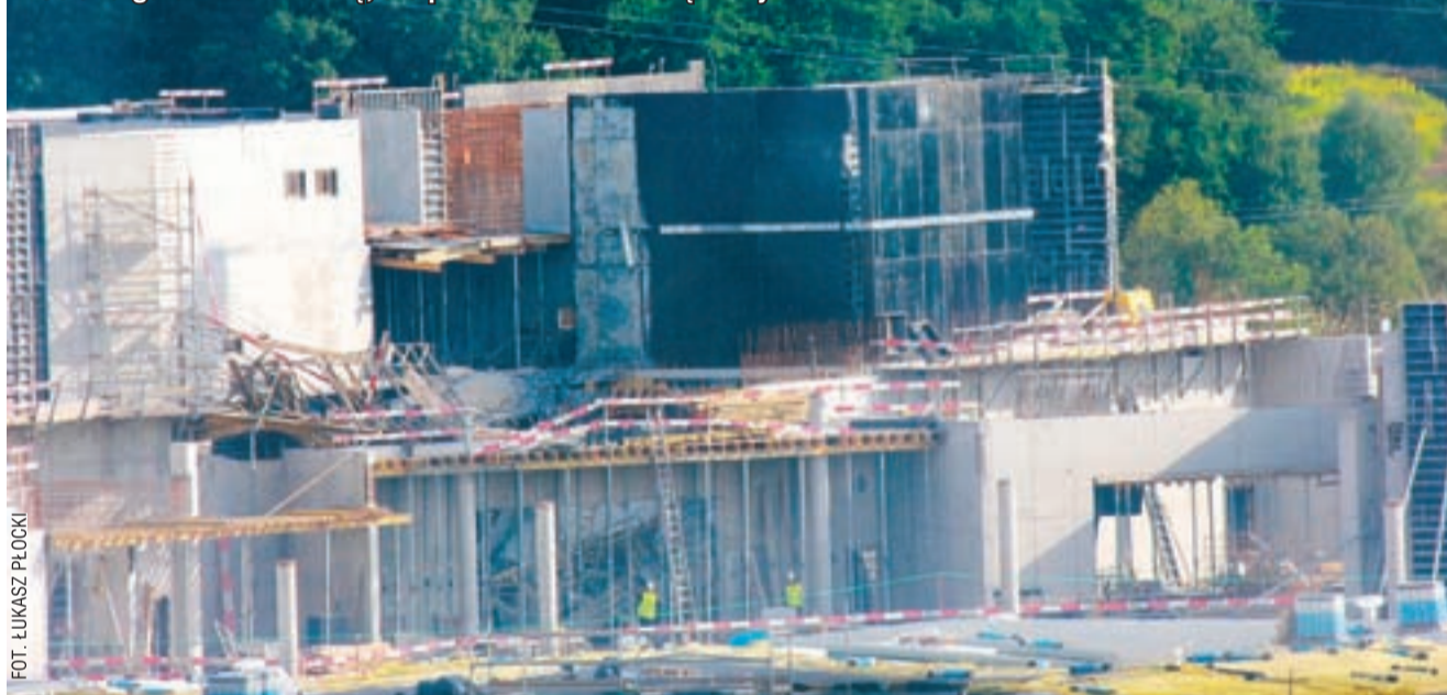
Ściana galerii zawaliła się, ale prace na budowie są kontynuowane.
