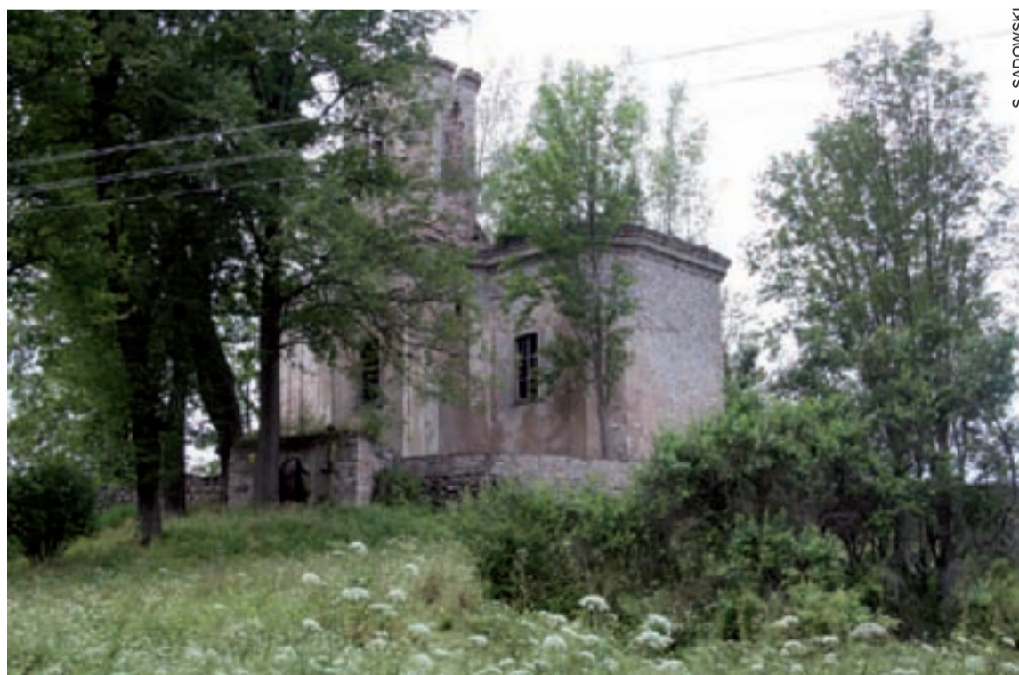
Kościół św. Mateusza grozi zawaleniem. Czy mające ruszyć w najbliższych dniach prace uprzedzą katastrofę budowlaną?
