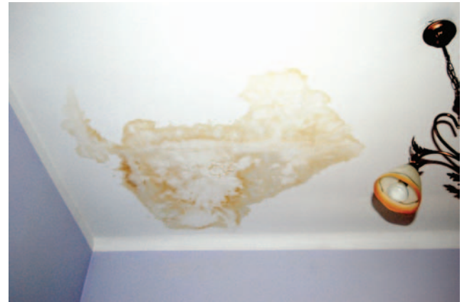
Takie plamy zostały po rozpoczętym remoncie dachu
