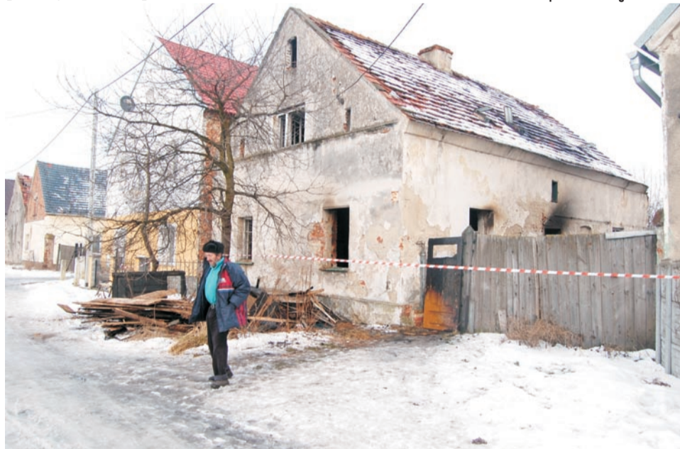
W domu wszystko spłonęło. Nadzór budowlany zakazał wstępu
