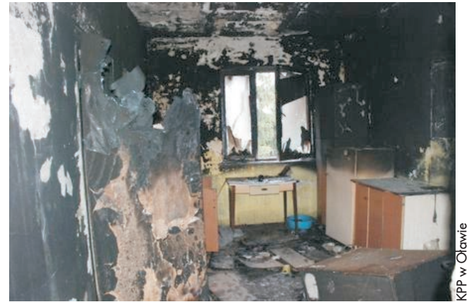
Spalone mieszkanie nie nadaje się do użytku
