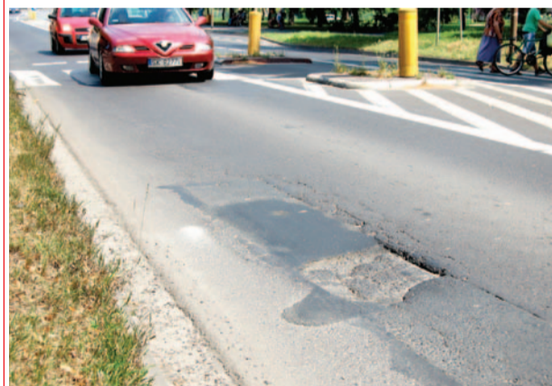
Zniszczony fragment drogi przeszkadza mieszkańcom i kierowcom
