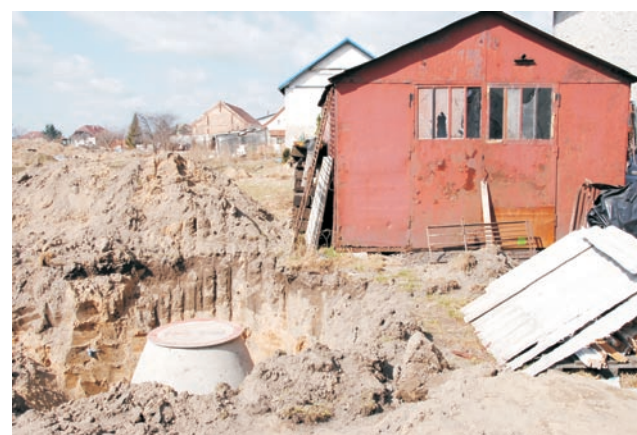
Tam, gdzie trwają prace, straszą niezabezpieczone doły
