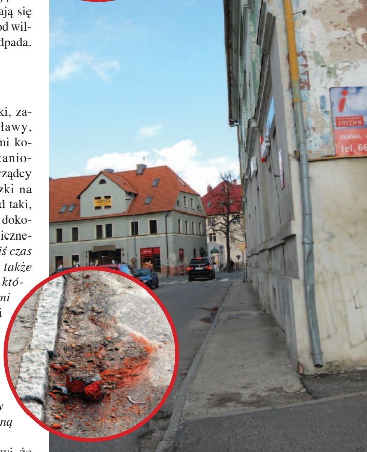
Z budynku przy ulicy św. Rocha spadają cegły...
