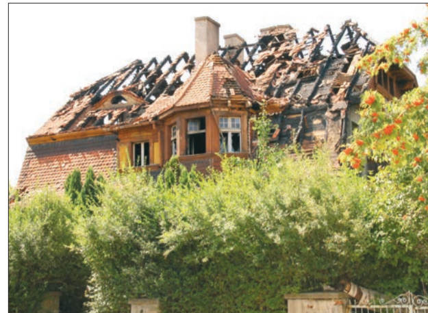
Dach budynku splonął niemal doszczętnie
