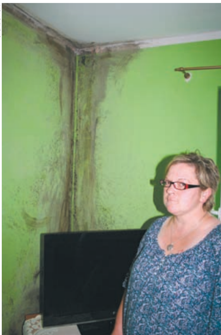
Mieszkanie Katarzyny Cembali z miesiąca na miesiąc ogarnia coraz większa wilgoć i grzyb
