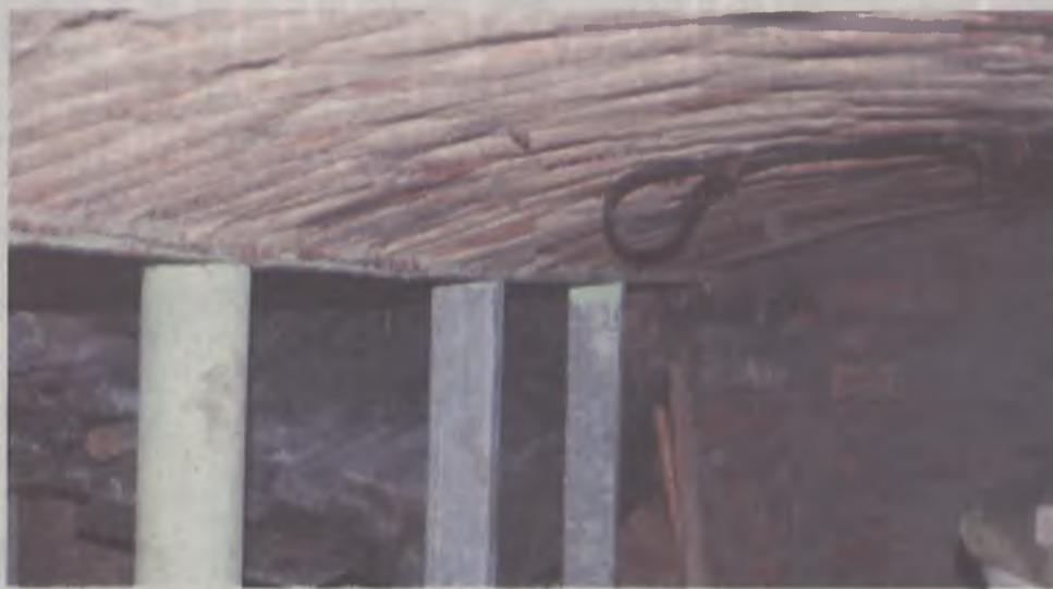
Mieszkańcy podparli strop rurami i deskami
