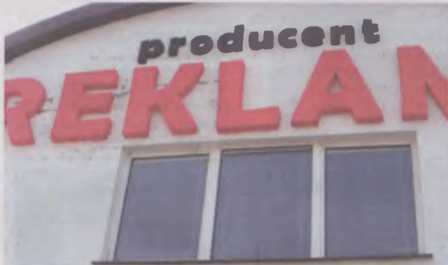
Pęknięcia na niedawno postawionym budynku, w którym działa m.in. firma „Producent Reklamy”
