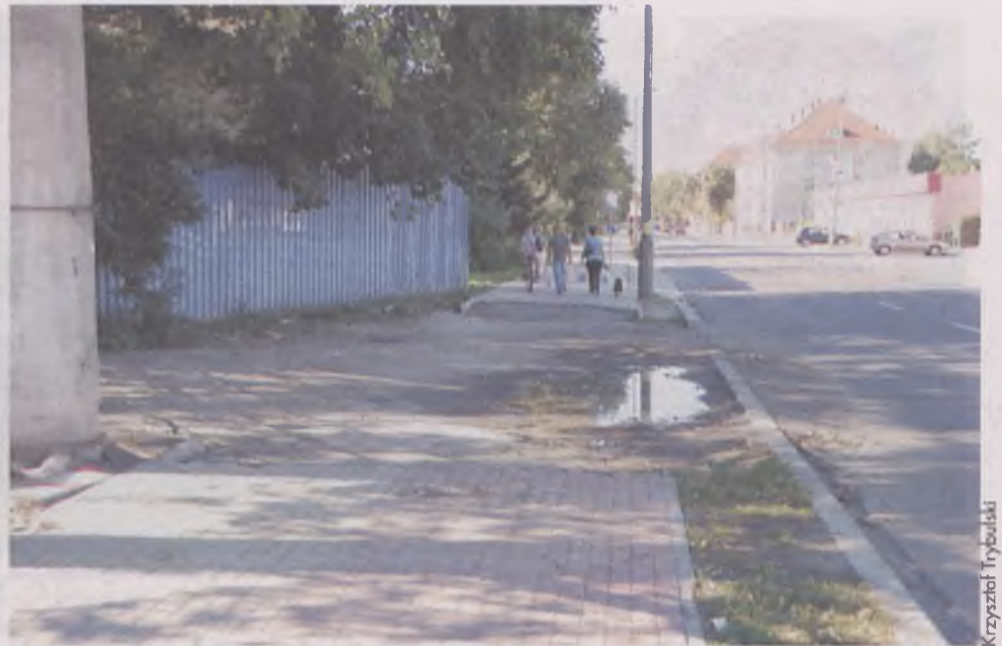
Fuszerka czy może „planowa przerwa inwestycyjna”? Niedokończony chodnik i rozgrzebana ścieżka rowerowa przy ulicy 3 Maja
