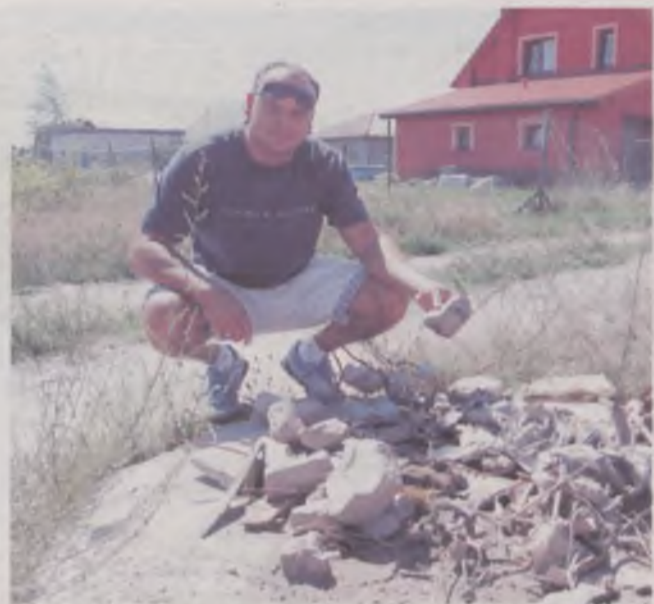
Dziury w ulicy Brzozowej wypełniano fragmentami uzbrojonego betonu
