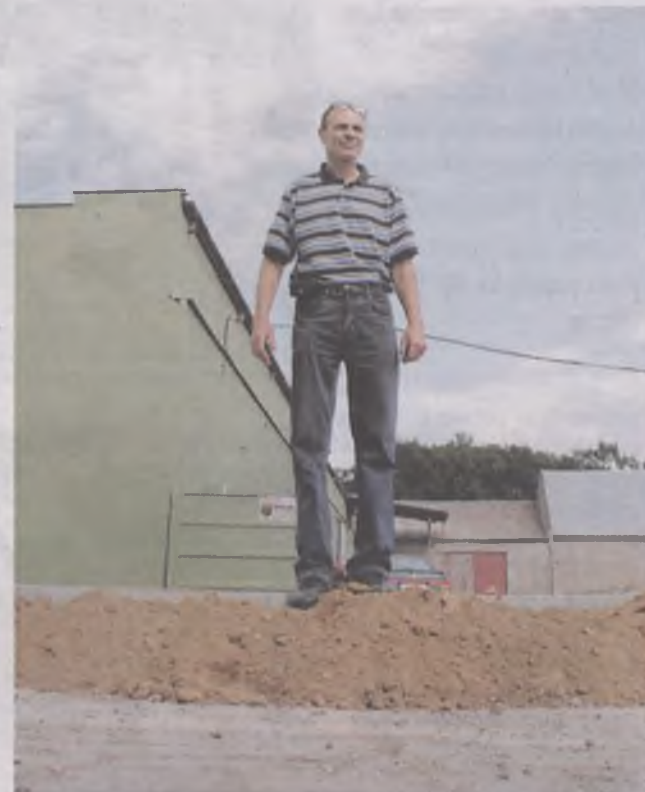
Mieszkaniec Pełczyc pokazuje, jaka jest różnica w wysokości pomiędzy wykonywanym chodnikiem a poboczem przed posesją
