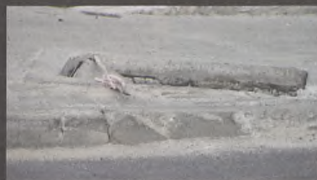
Tiry uszkodziły nowy chodnik, zapadła się studzienka
