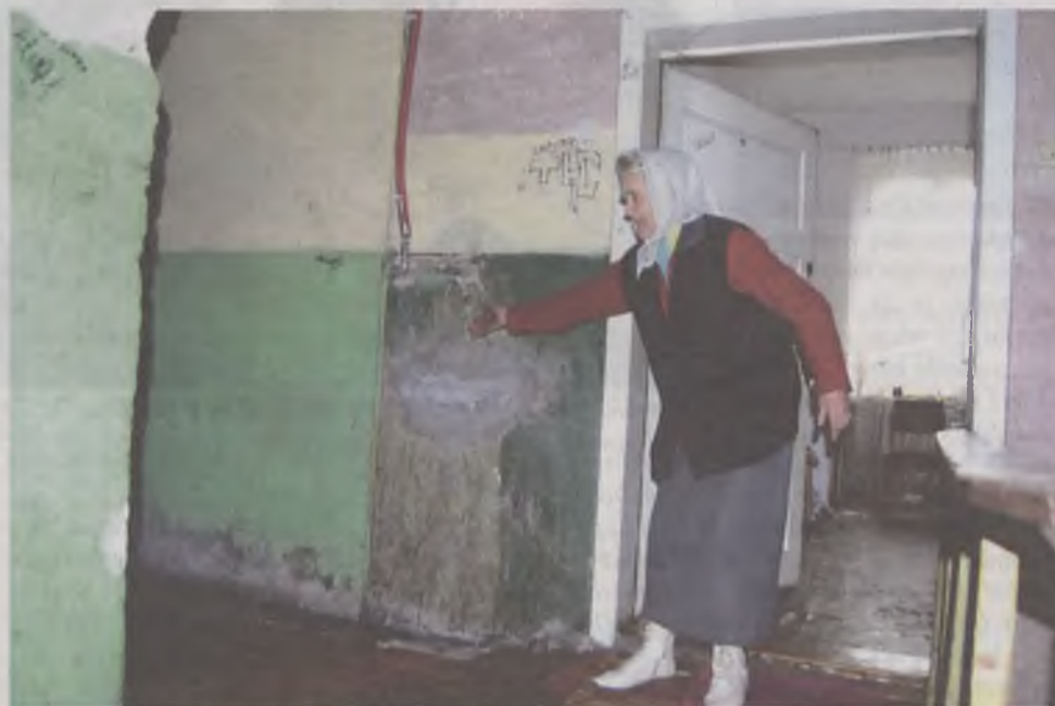
Uciążliwy mieszkaniec załatwiał się do umywalki przy drzwiach Bronisławy Szymańskiej. W końcu sprzedał „pisuar” na złom, ale wciąż sika na klatce schodowej. Teraz na podłogę i ściany
