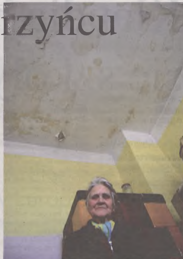
Zalany ściekami sufit to kolejny problem Bronisławy, Sąsiadka, która doprowadziła do awarii, wyjechała. Nie zamierza płacić za szkody
