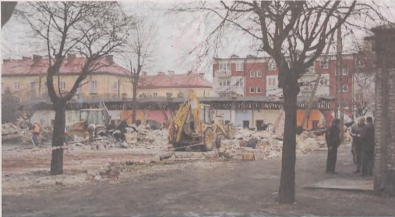
Na miejscu zburzonych baraków powstaną dwa bloki TBS. Ostatni zamieszany barak ma zniknąć za 1,5 roku
