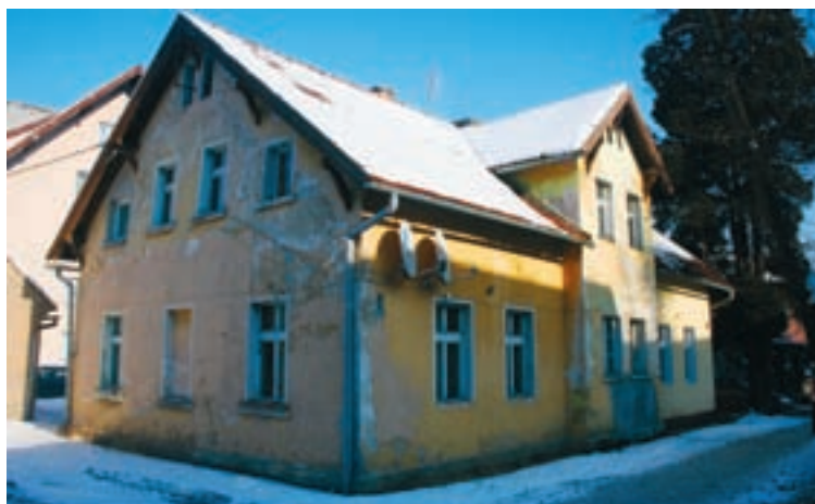
Niskie czynsze oznaczają, że nie ma pieniędzy na remonty. Domy wyglądają tak, jak ten przy ul. Żymierskiego w centrum Piechowic.
