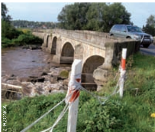
Prace na zniszczonym moście w Brunowie mają się rozpocząć w połowie września.
