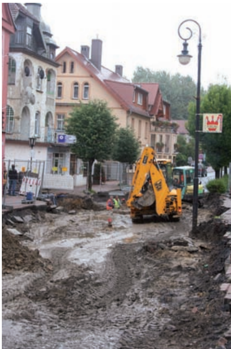
Wielu kuracjuszy narzeka na rozkopany Świeradów Zdrój. Za to ci, którzy przyjadą za rok, będą już spacerować po efektownym deptaku.
