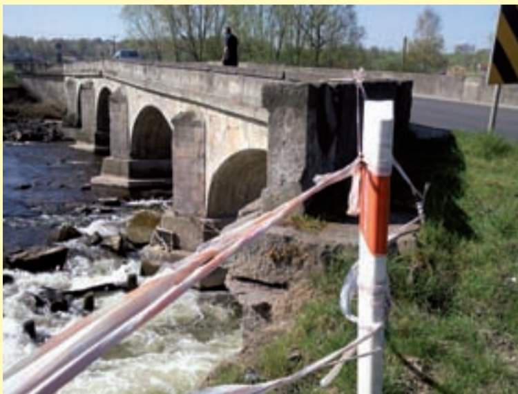
Przyczółek mostu runął osiem miesięcy temu i do dziś nie został naprawiony.
