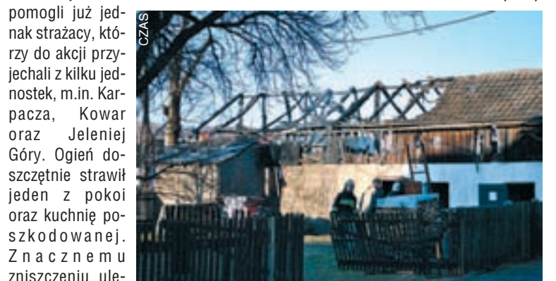
Dom w Mysłakowicach po pożarze nadaje się już tylko do rozbiórki.
