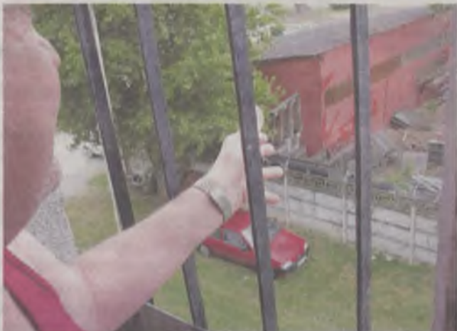
Przerwa między szczebelkami nie spełnia norm architektonicznych
