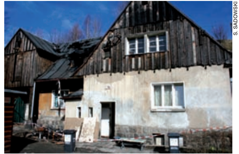
Budynek przy ul. Morcinka 1A po pożarze i akcji ratowniczej nadaje się już tylko do rozbiórki.
