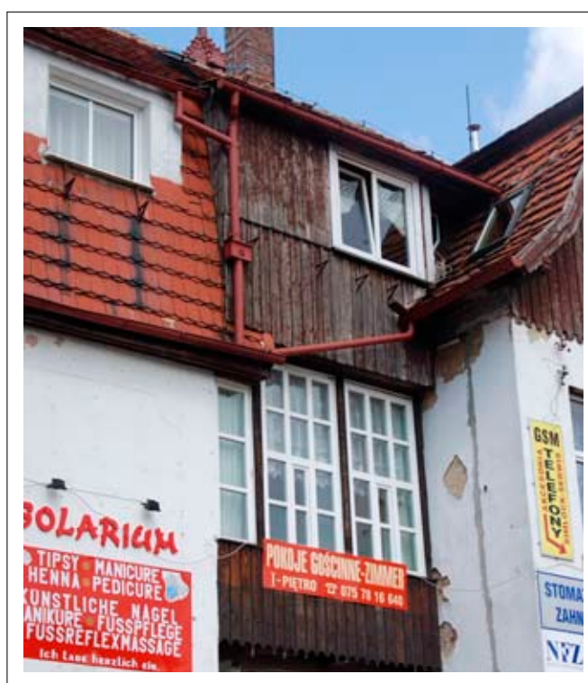
Zabudowa drugiego poziomu werandy asymetrycznymi oknami z PCV
