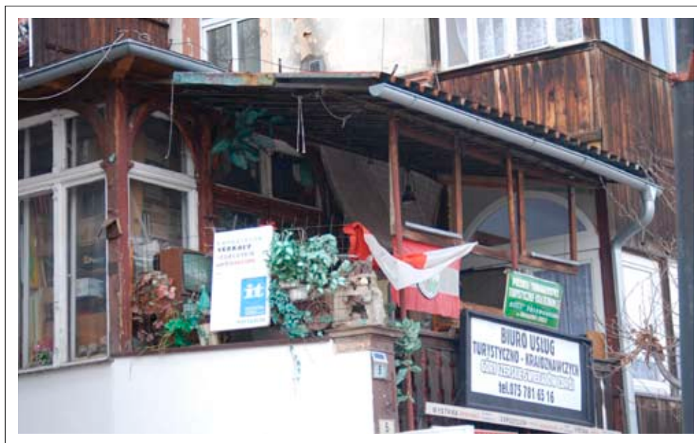
Zabudowa werandy współczesnym zadaszeniem z blachy i montaż reklam
