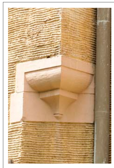
Szpital Wysoka Łąka w Kowarach – podpora kamienna
